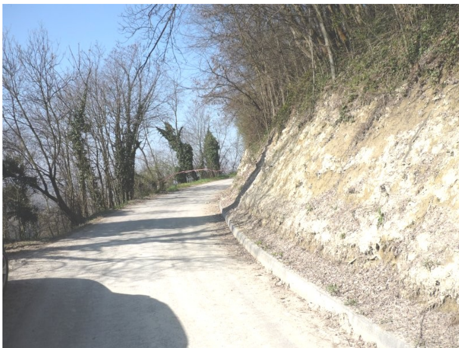
Foto 9.4 – Particolare della Frana per saturazione e fluidificazione della coltre superficiale (61-FA9) innescatasi in corrispondenza della scarpata di monte di un tratto della sede stradale di Via Bava.
