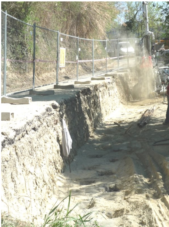
Foto 9.5 – Particolare del fenomeno franoso 60-FS9 in cui si evidenziano gli interventi di sistemazione in corso, rappresentati da una paratia di micropali accoppiati a tiranti e da opere di regimazione delle acque.
