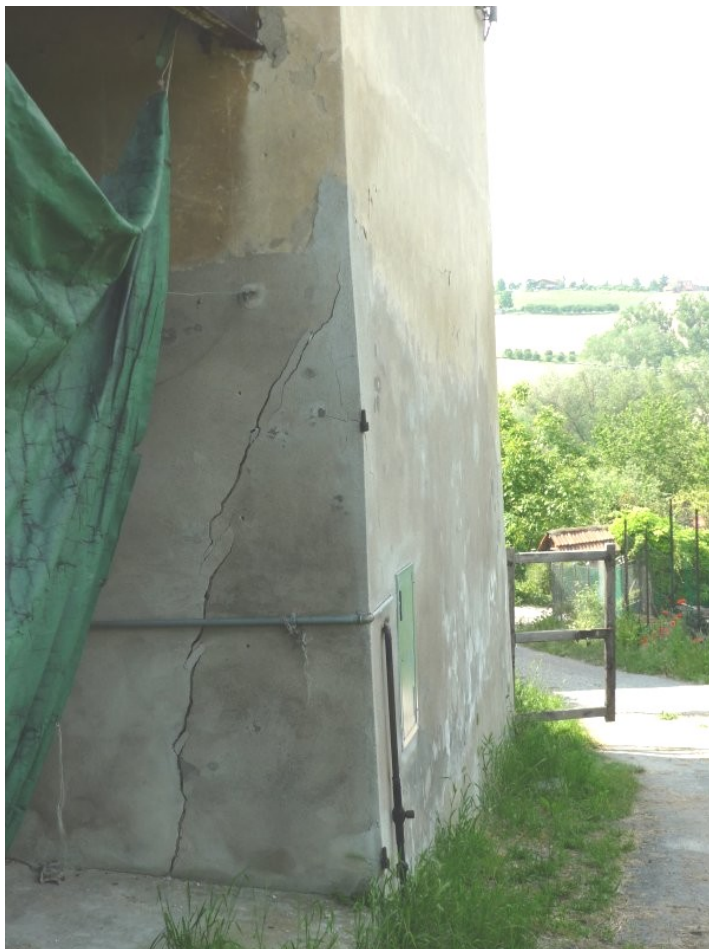
Foto 9.3 – Particolare di lesioni ai fabbricati: nel caso in esame si tratta di uno dei fabbricati posti a monte del fenomeno franoso 50-FA10.
